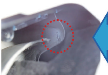
画像⑥わずかに損傷跡が確認できます
