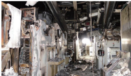
ルネサスの火災現場
