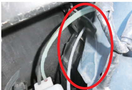
画像③先端部分のステアは損傷リスク大 (同)
