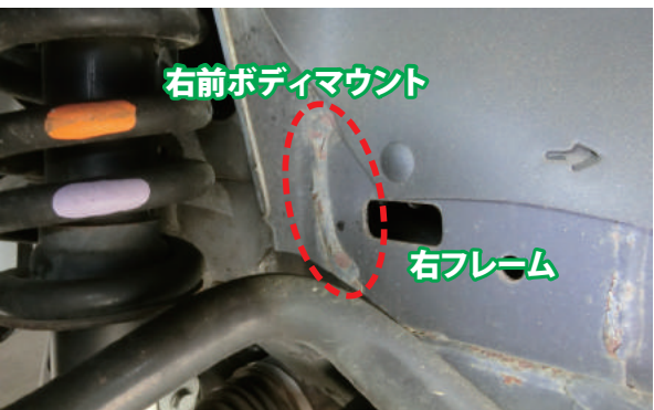
画像③ ボディマウント溶接部分に生じた損傷
