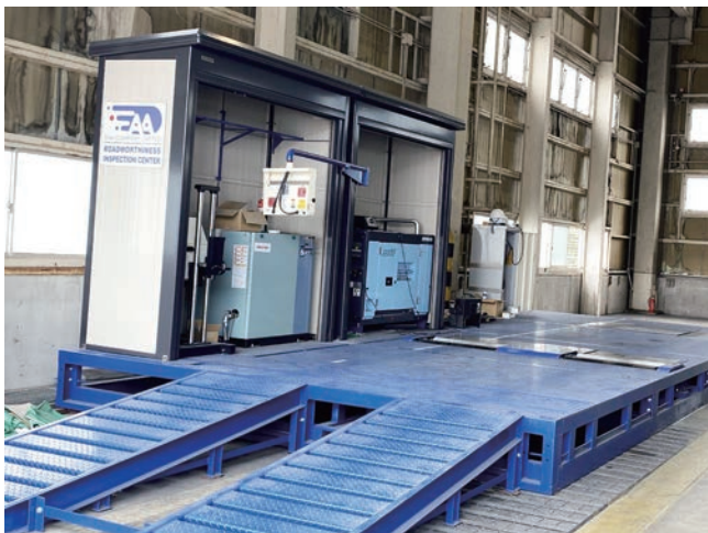
画像③分割式設置型検査施設
