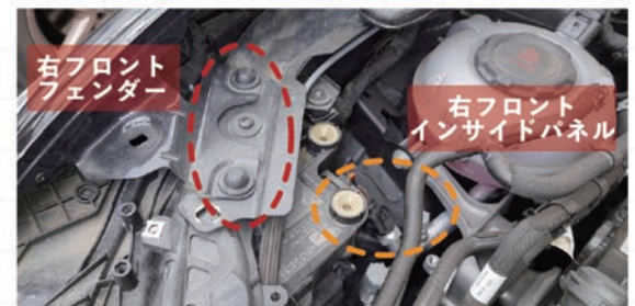
画像③フロントインサイドパネル先端部確認は検査用ライト必須
